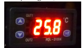
digitale Anzeige und Lüftersteuerung
